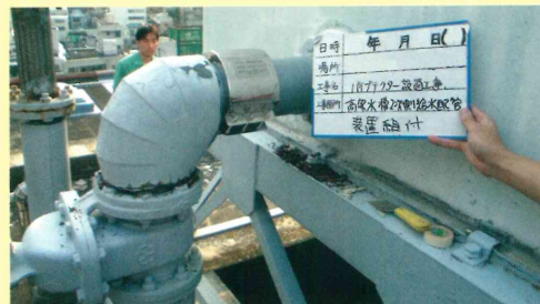
高架水槽二次側配管 PT-125DS 築20年・7階建
